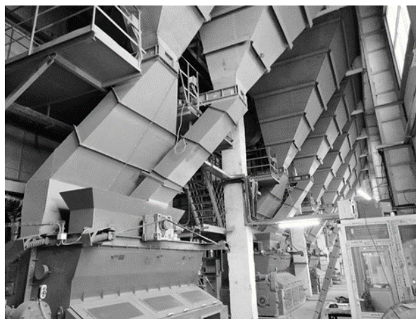
Рис. 3. Котли «Радіант» Хоростківського цукрового заводу, переобладнані на спалювання пелет з рослинної біомаси та/або газового вугілля.
